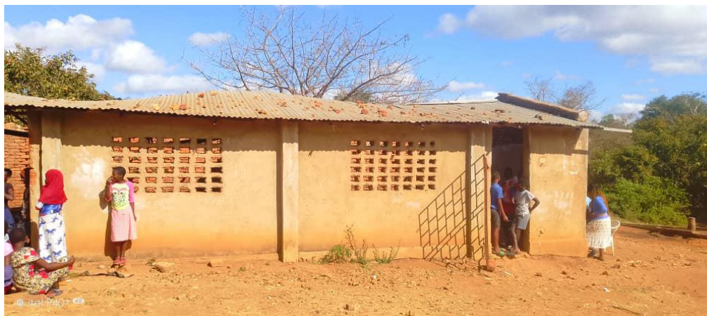
De school in Msosa waarvan het dak is ingestort. Na de regens is er meer schade bijgekomen.
